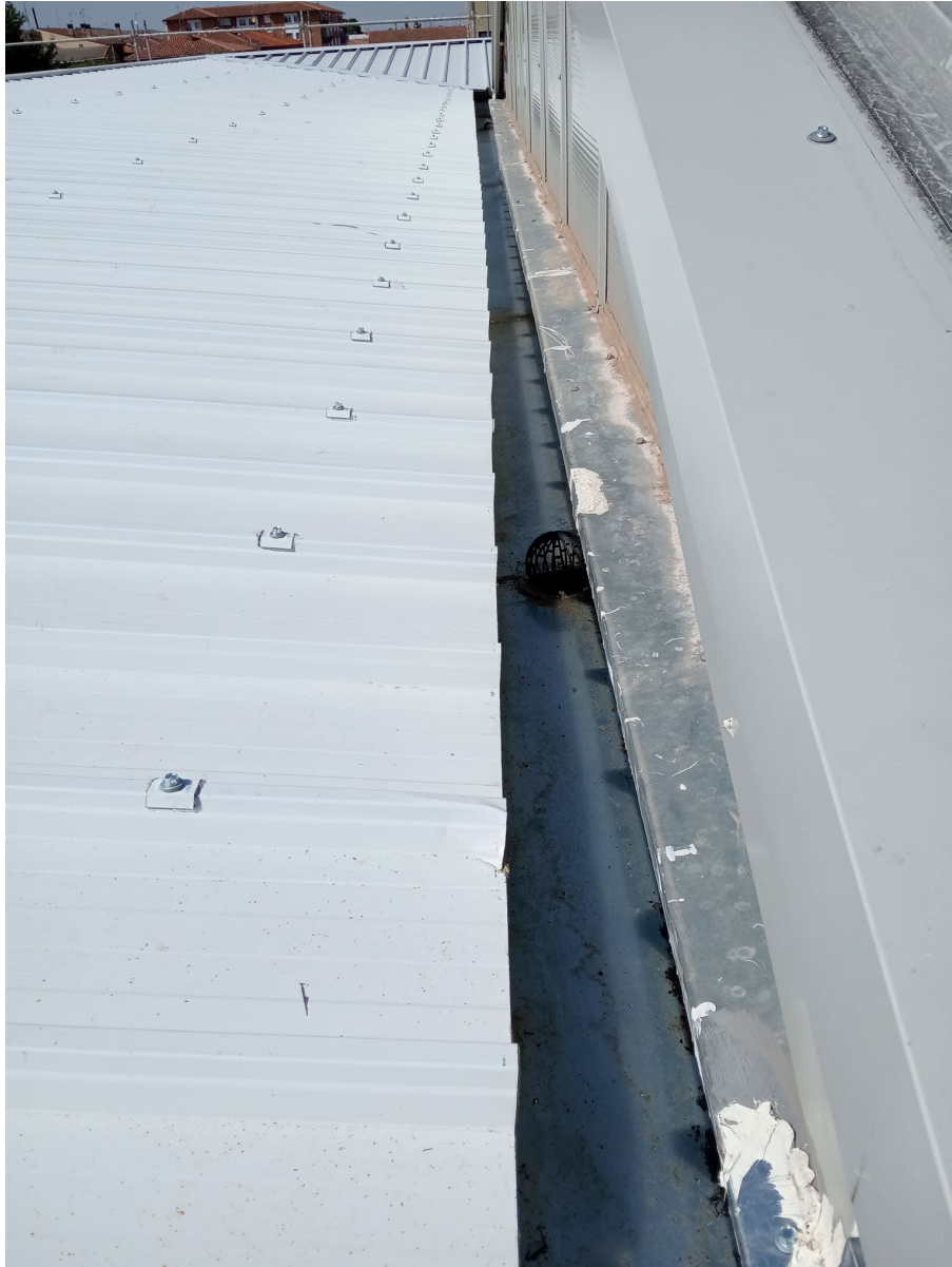
FOTO 3: Nuevos canalones ampliados.
